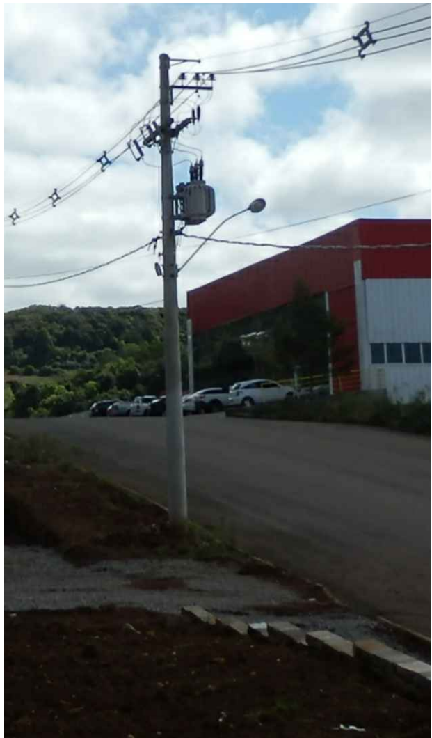
POSTE N.º 14 Subestação n.º 749971
